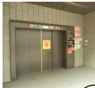
機械式駐車場
