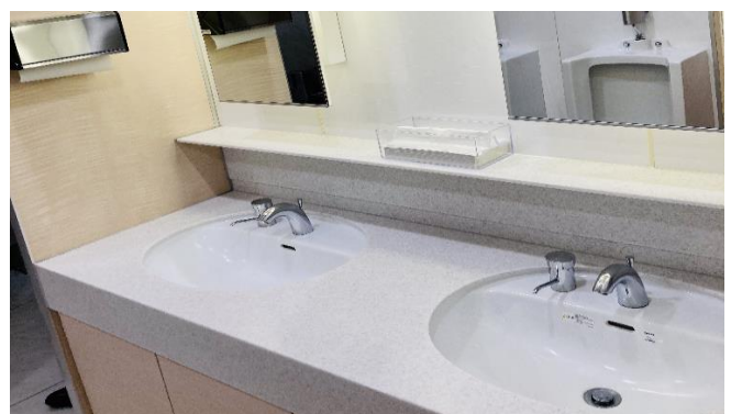
■トイレ洗面台
