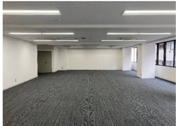
■基準階貸室(LED照明設置)
